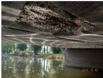
Brug met beton schade,
