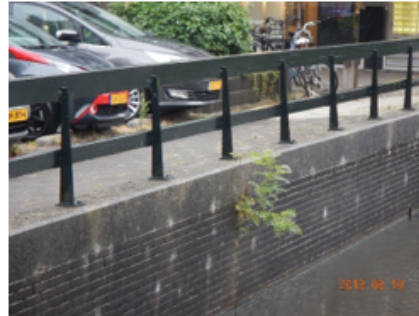
Kademuur met scheurvorming
