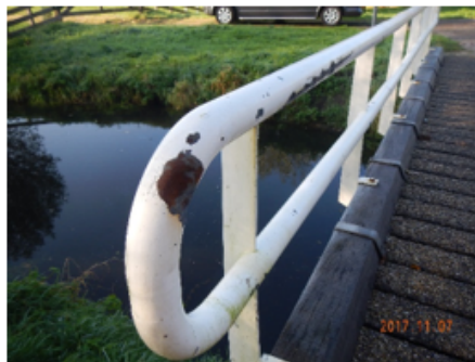
Brug met schade
