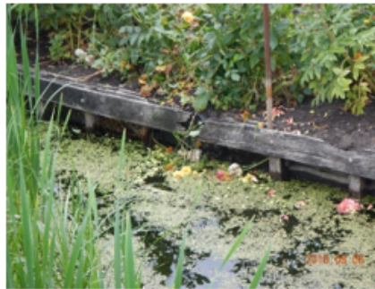
Oeverbescherming met schade
