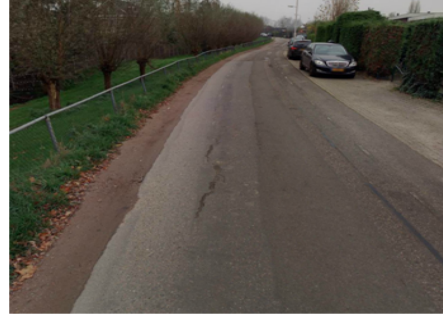
Asfalt weg met scheurvorming, Ronde Hoep Oost
