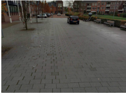
Elementenverharding met ernstige schade, Vondelstraat Foto 1 t/m 4 Voorbeelden wegtypes en schades
