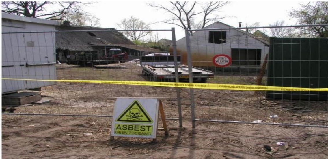
Figuur 13: Afscherming van een asbestverdachte locatie
