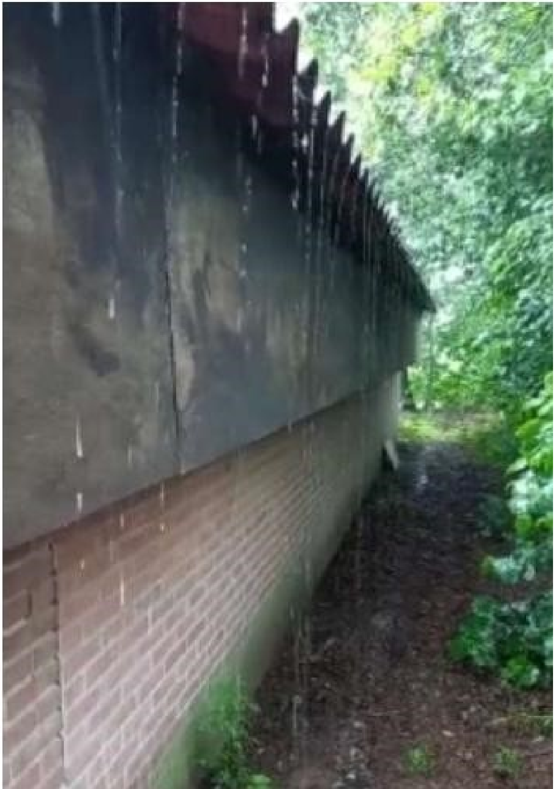
Figuur 2: Voorbeeld van de drupzone zonder verharding onder een asbestverdacht dak Asbest en PCB's
