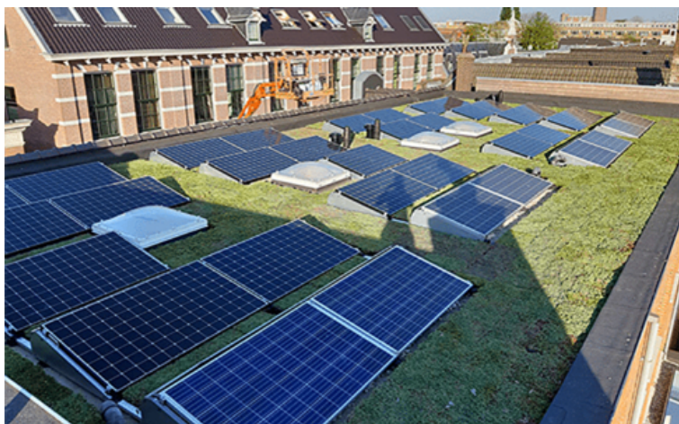
Groen dak met zonnepanelen
