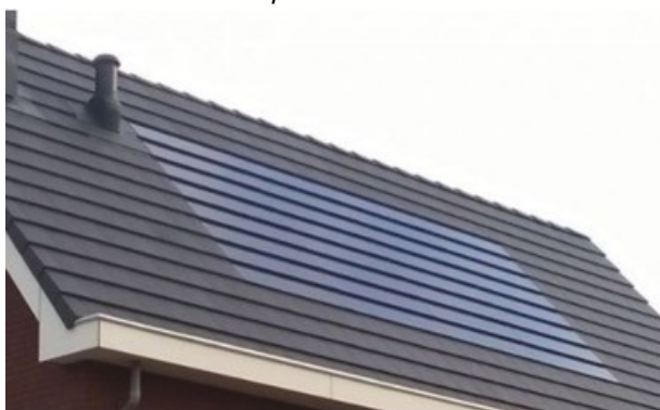
zonnepanelen geïntegreerd in het dak
