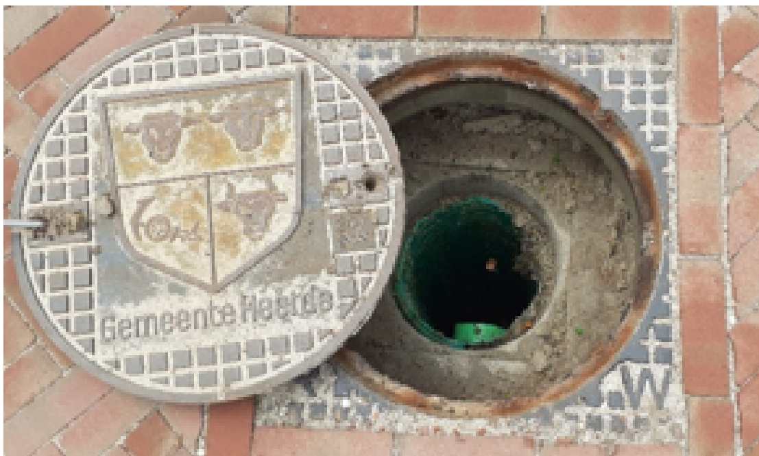
Figuur 3: Voorbeeld infiltratieput in gemeente Heerde
