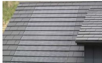
Dak met geïntegreerde pv-panelen
