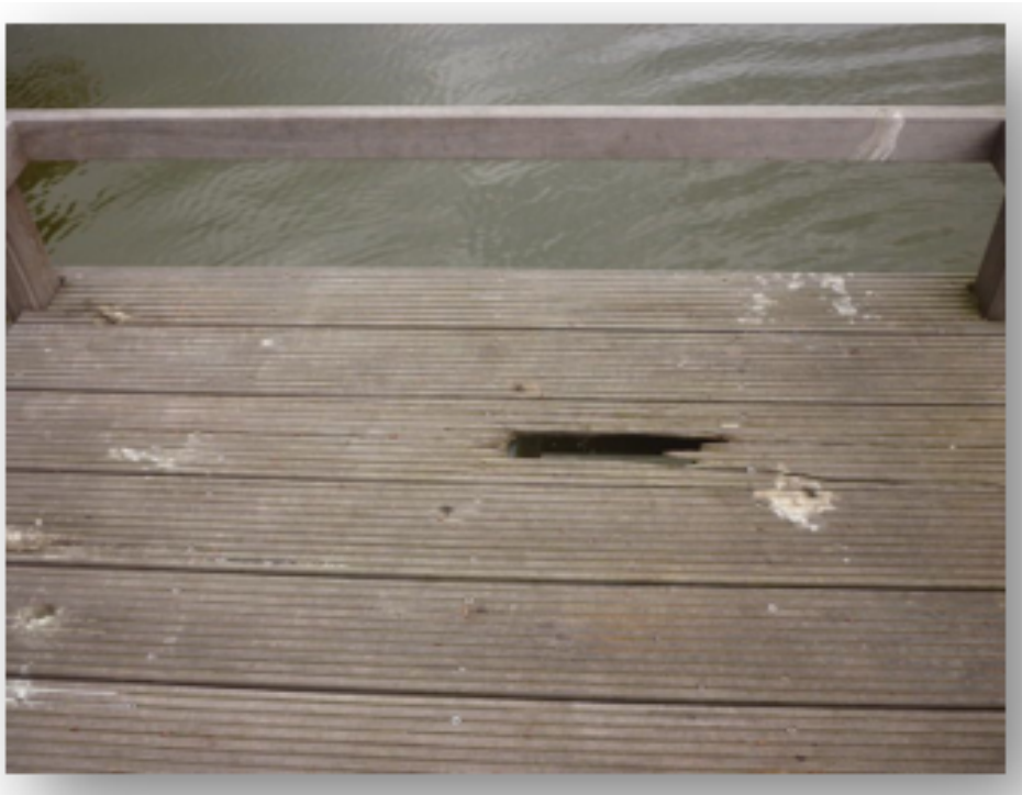
Figuur 3: Schade aan dekplank steiger. Een reële kans op risicoaansprakelijkheid. Hier is direct herstel – klein onderhoud – vereist
