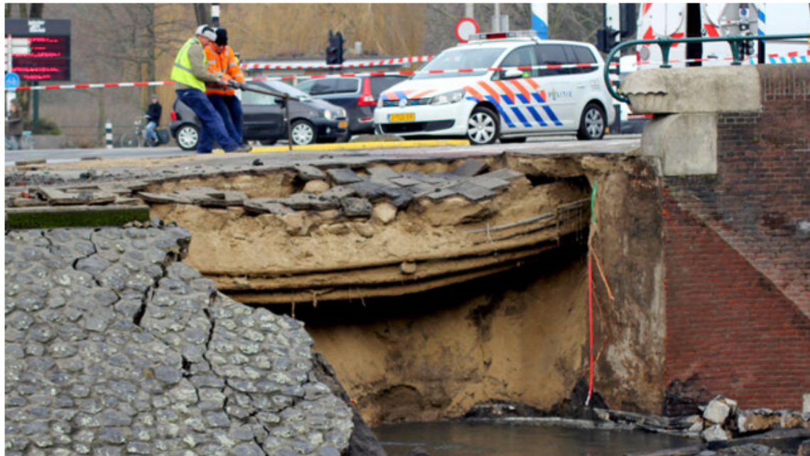
Figuur 6 Een ingestort stuk kademuur bij de Nassaukade in maart vorig jaar (Bron ANP)
