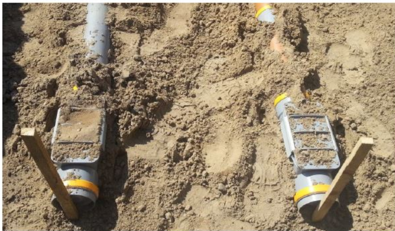
Gescheiden inzameling in Valleipark, op de erfgrens twee ontstoppingspunten
