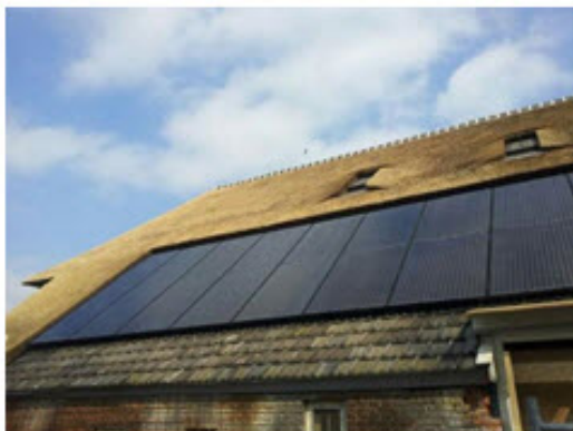
zonnepanelen panelen onderzijde rieten dak
