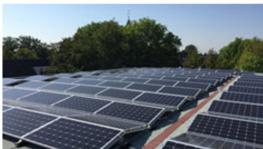
oostwest opstelling zorgt voor een rustig beeld bij platte daken (foto Sunbeam Nova)
