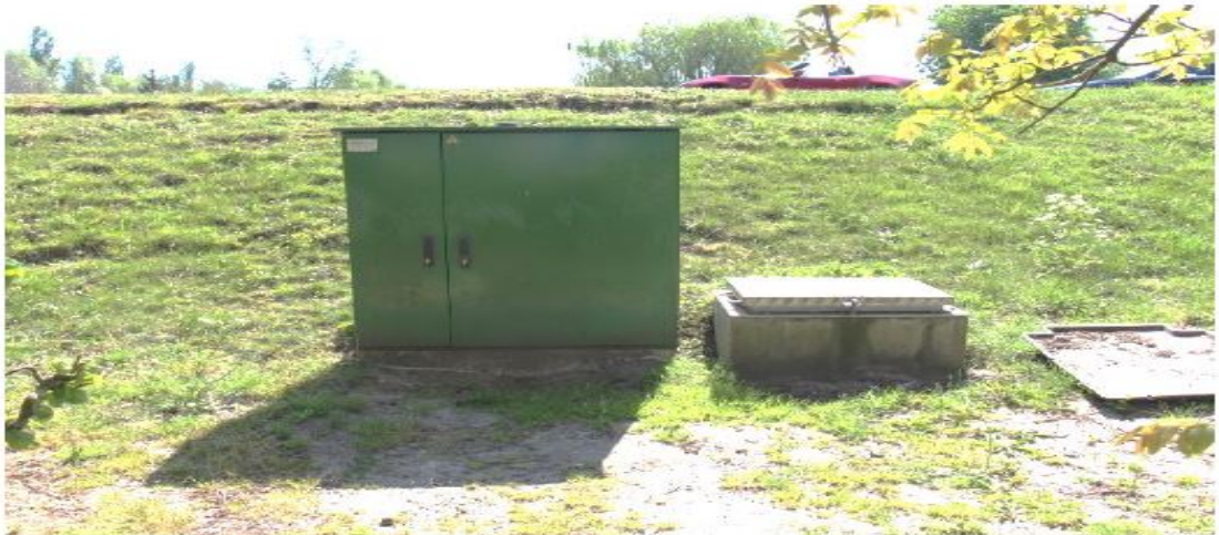
Gemaal met schakelkast (links) en pompput (rechts)
