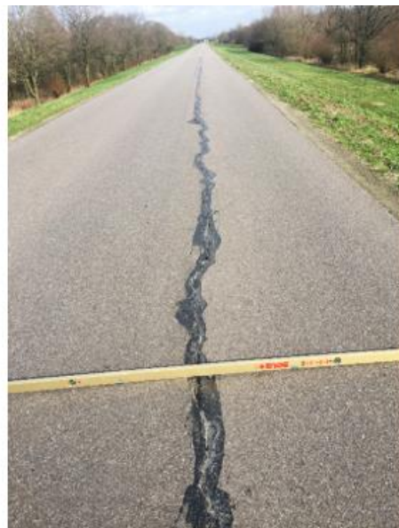
Scheurvorming in de dijkwegen door zetting dijklichaam
