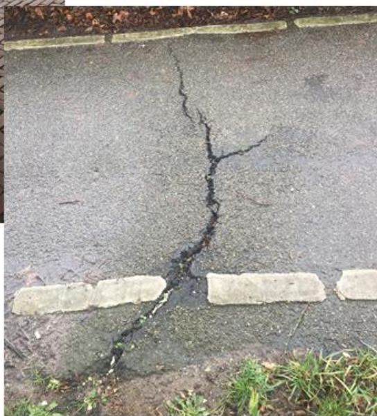
Schade door wortelopdruk in asfalt
