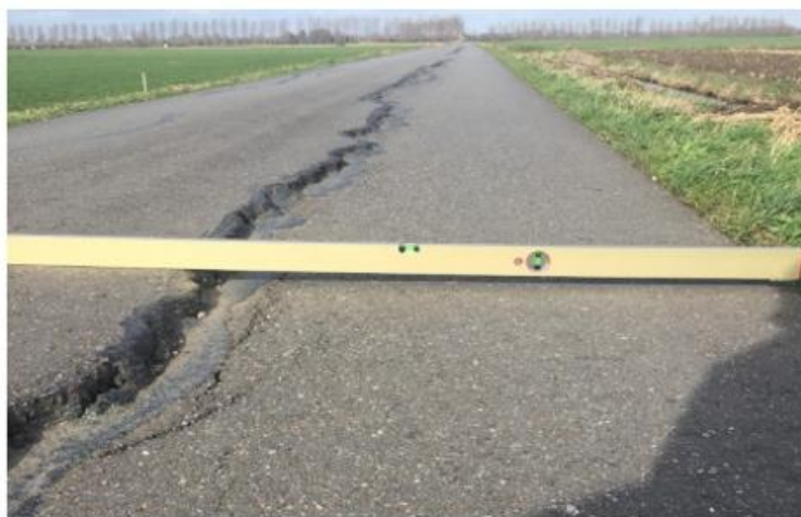
Afkantelen weg en scheurvorming door zetting ondergrond
