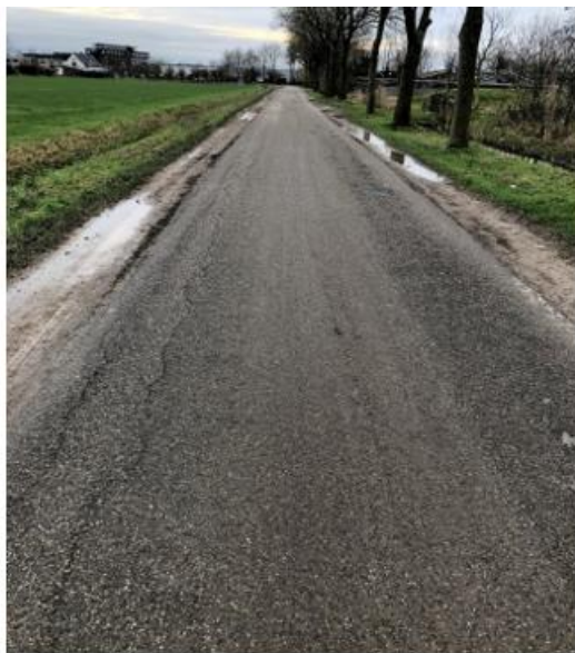
Typisch wegbeeld. Slechte bermen, scheurvorming en gaten (rechtsboven) deels gecamoufleerd door de slijtlaag
