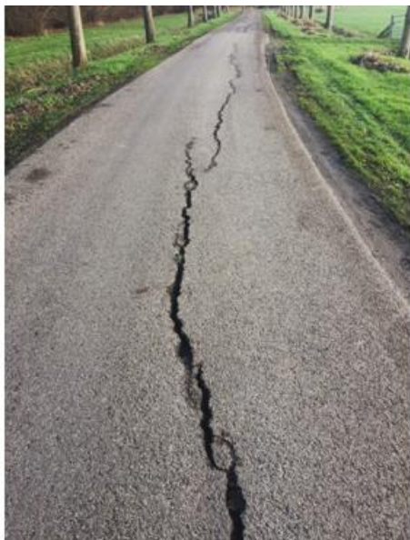
Scheurvorming vermoedelijk door droogte
