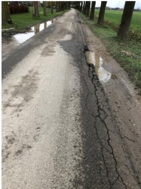
Gevaarlijke berm en forse randschade asfalt
