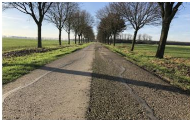
Lapwerk (met terugkerende schades) in afgeschreven weg
