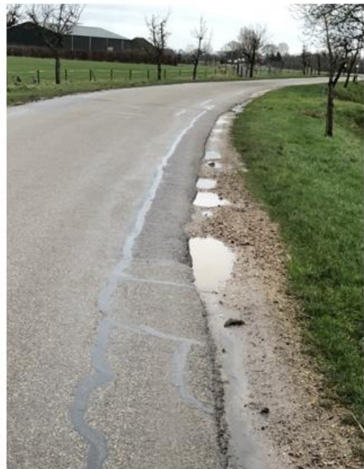
Herstelde en terugkerende berm en randschade asfalt
