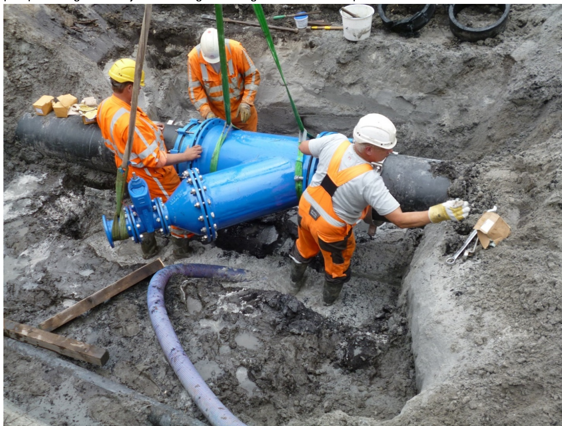
Figuur 14 – Aansluiting van een persleiding bij Kwadijk. (Bron: hoogheemraadschap Hollands Noorderkwartier)
