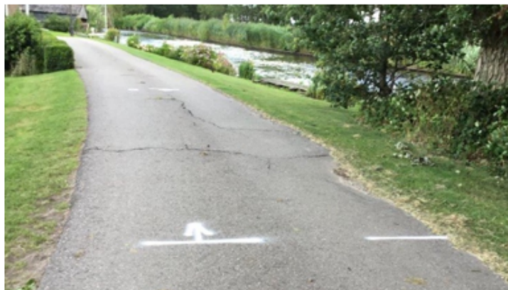
Figuur 6 Schade, hoogstwaarschijnlijk veroorzaakt door droogte
