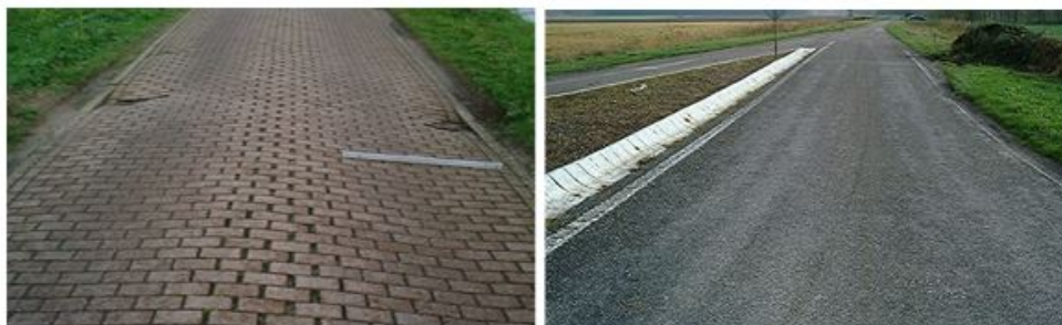
Figuur 2 Schades dwarsonvlakheid en rafeling
