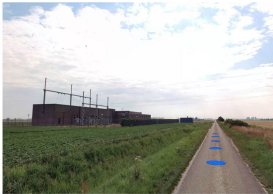
Figuur 2: het onderstation in de Cambronpolder
