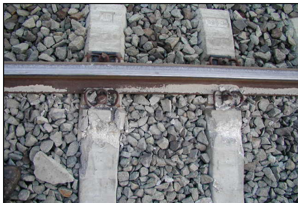
Afb.8: Betonnen dwarsliggers, beschadigd t.g.v. ontspoord draaistel.
