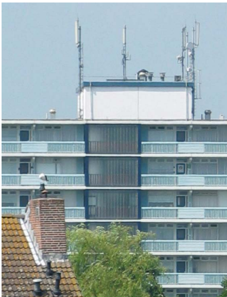
Figuur 8 Voorbeeld van een dakstelling van GSM-antennes
