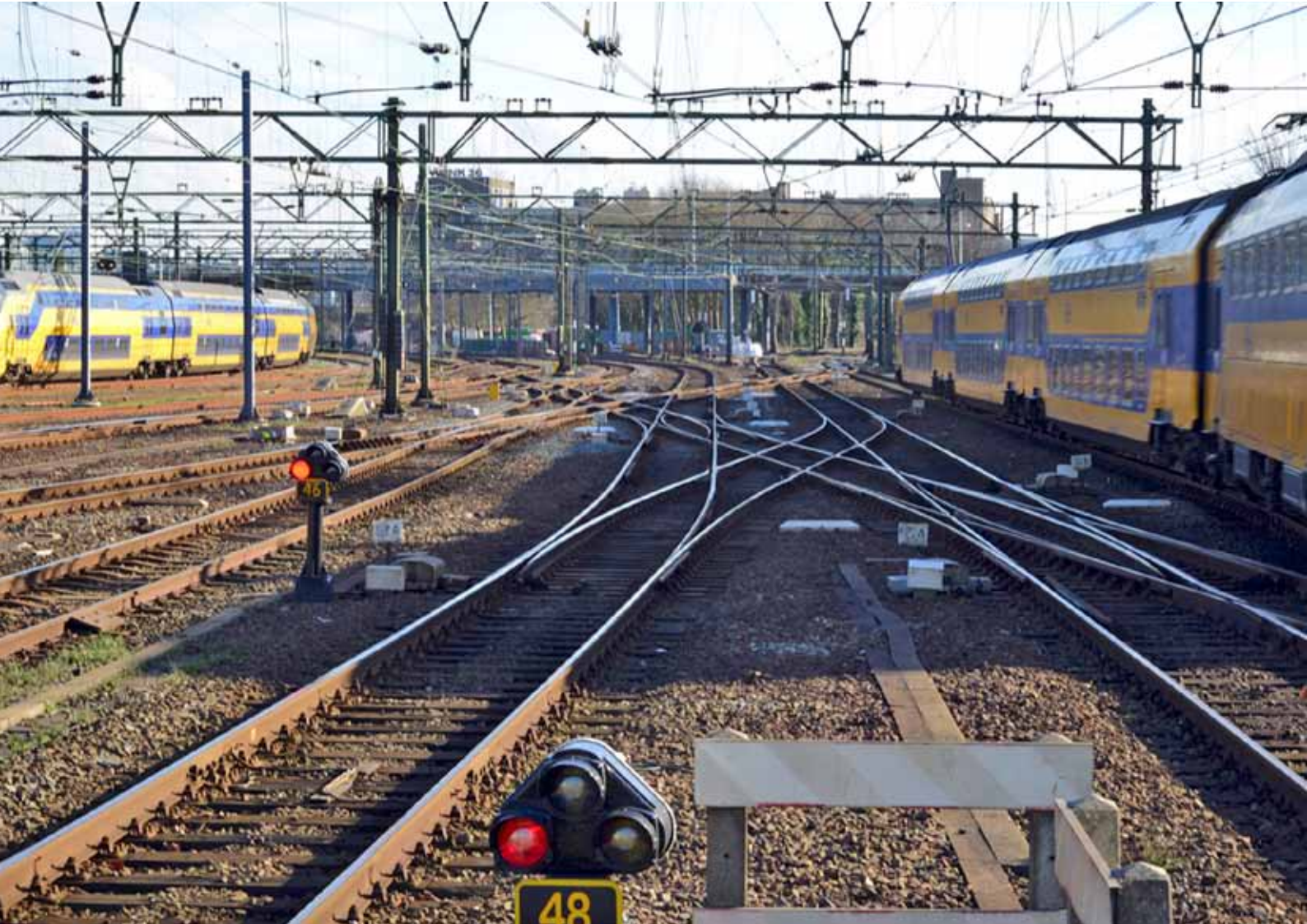
Seinen langs het spoor zijn verleden tijd bij ERTMS Level 2. (Foto: Jos Braal)
