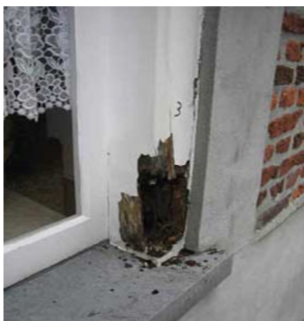
Vergunning vervangen verrot kozijnhout?
