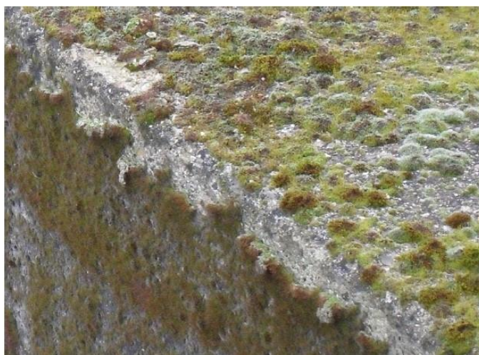
Figuur 5.5: Plaatselijke schade aan het betonoppervlak van een stempel (foto B.20 in [02])
