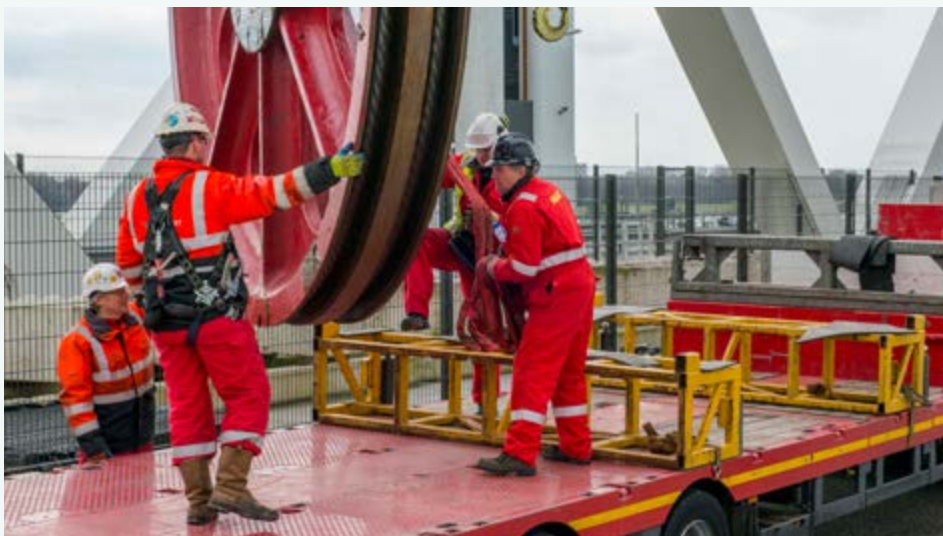
Omloopwielen van de hefinstallatie worden preventief vervangen om de bedrijfszekerheid van de Botlekbrug te vergroten. (BRON CEES VAN DER WAAL FOTOGRAFIE EN FILM)
