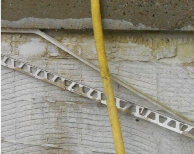
Afbeelding 1.2. Delaminatie tussen tegelwerk en lijmlaag
