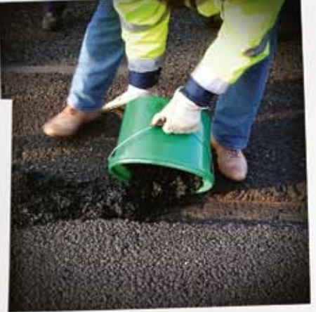
Vorstschade aan het wegdek
