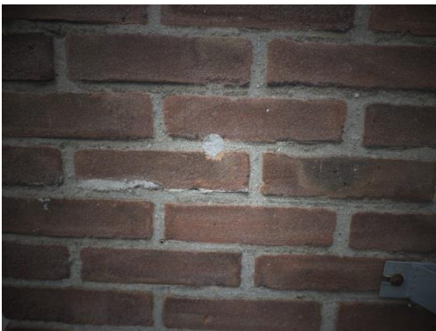
Figuur 45: Boorgaten bij woning 134
