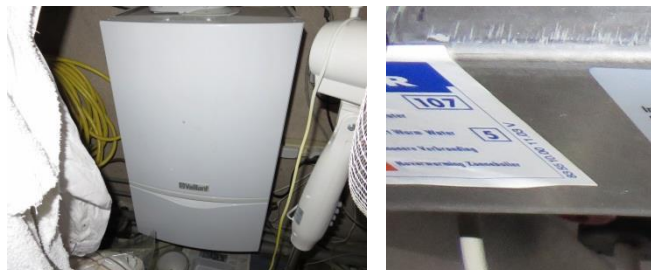
Figuur 4: CV-ketel met gaskeurlabel woning 2
