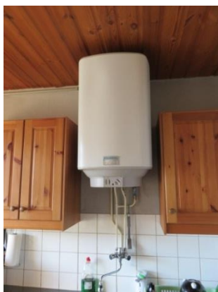
Figuur 11: Elektrische boiler woning 15
