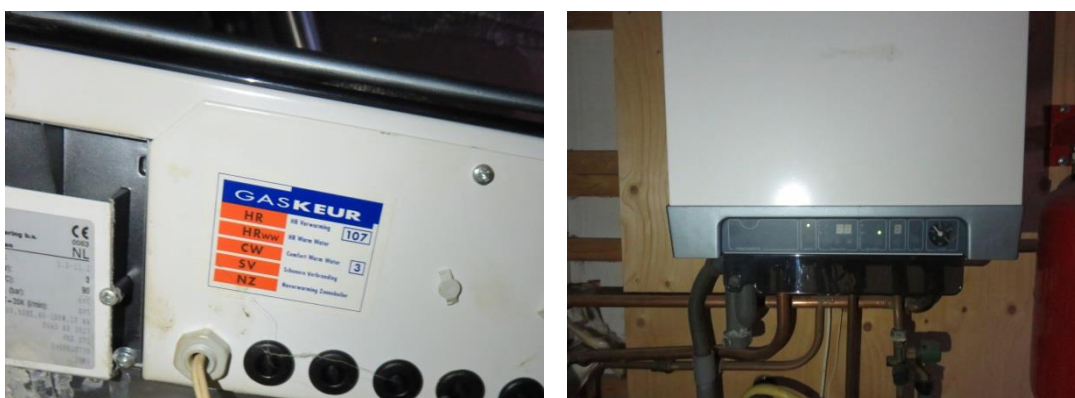
Figuur 16: CV-ketel woning 42
