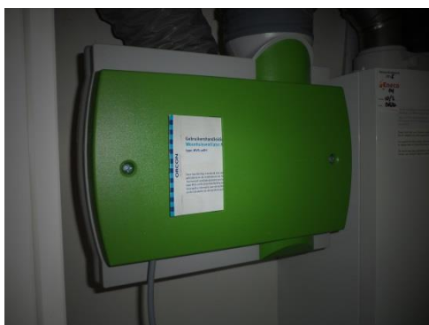
Figuur 24: ventilatieafvoer unit woning 65
