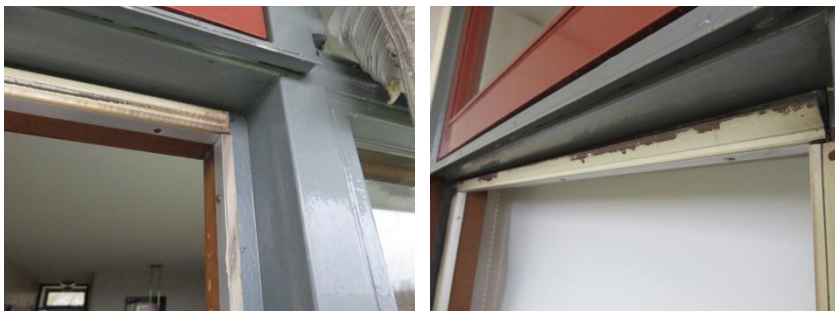
Figuur 10: Kierdichting rondom kozijnen
