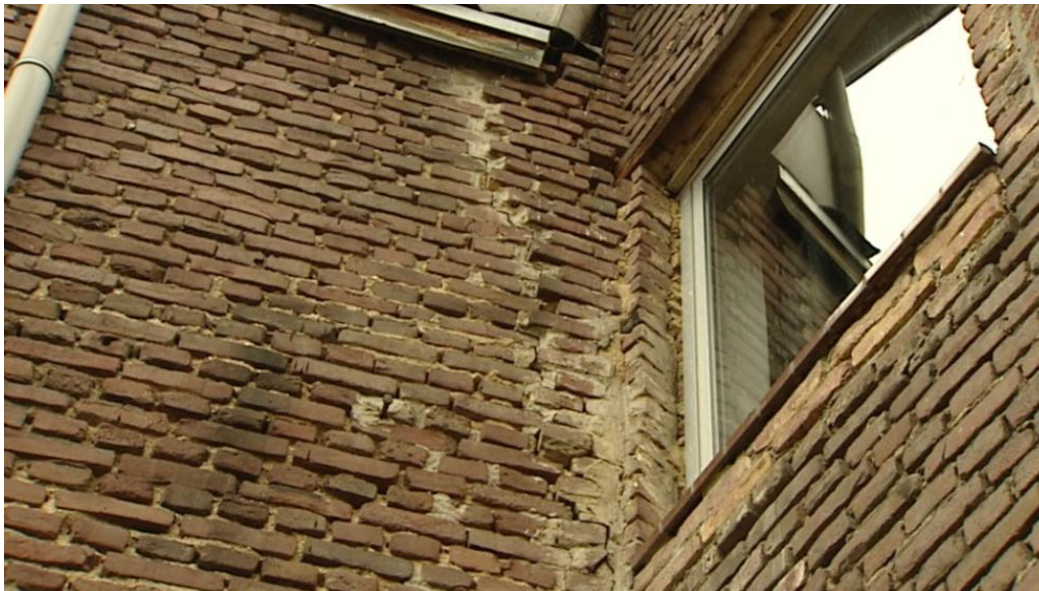
Figuur 4 Funderingsproblemen door mijnbouw in Rimburg (gemeente Landgraaf)
