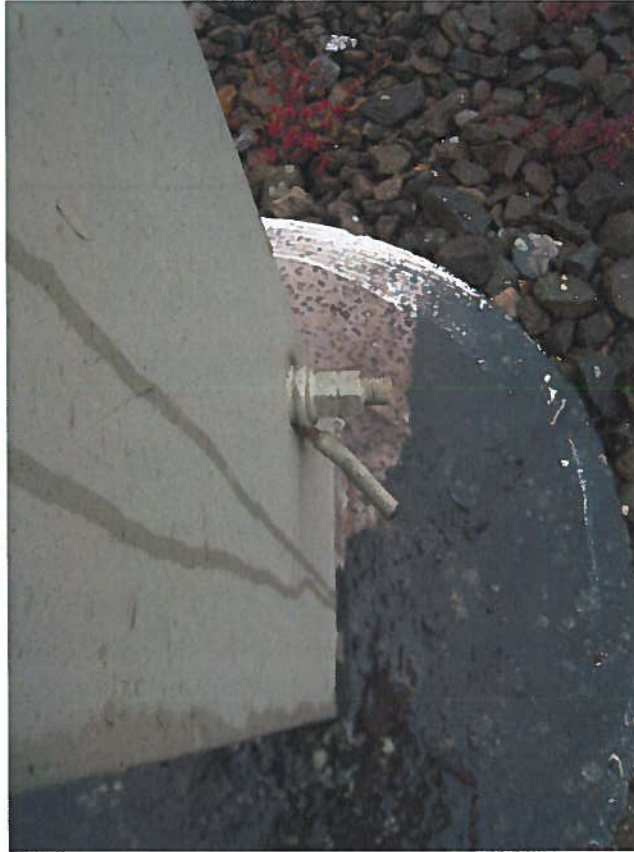
Figuur 16. Ontbrekende paalspoorstaafverbinding te Goes, Zeeland
