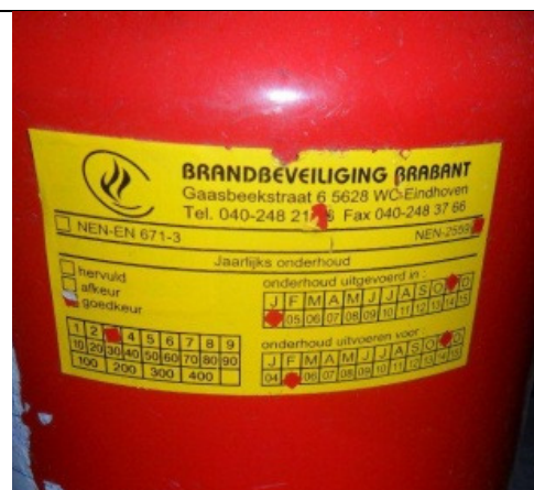
Brandblusser niet goed onderhouden, keuring verlopen
