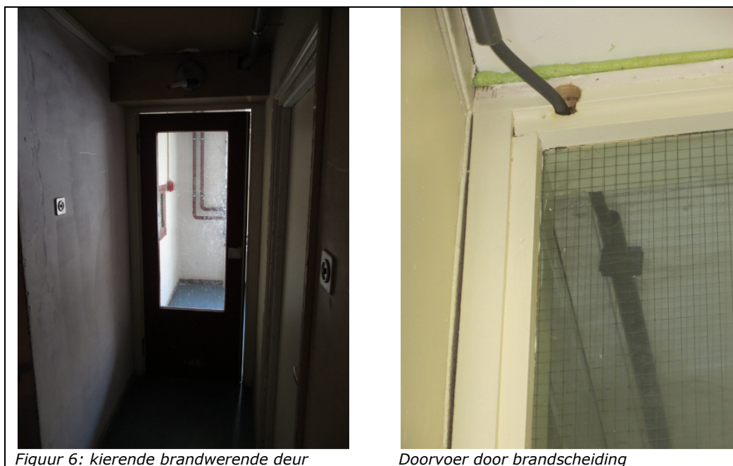
Figuur 6: kierende brandwerende deur
