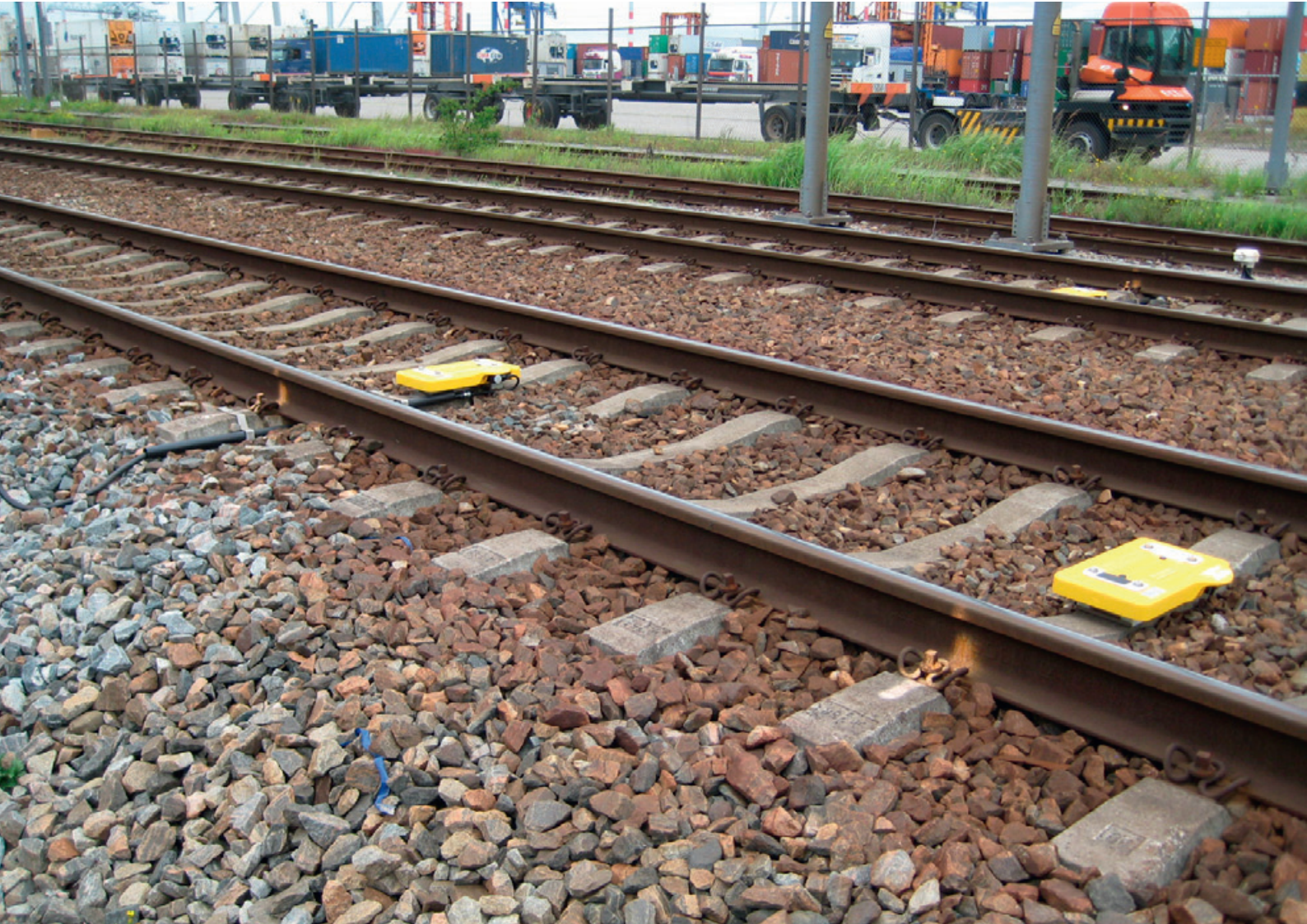
Eurobalises in het spoor. Deze werken als baken bij ERTMS.
