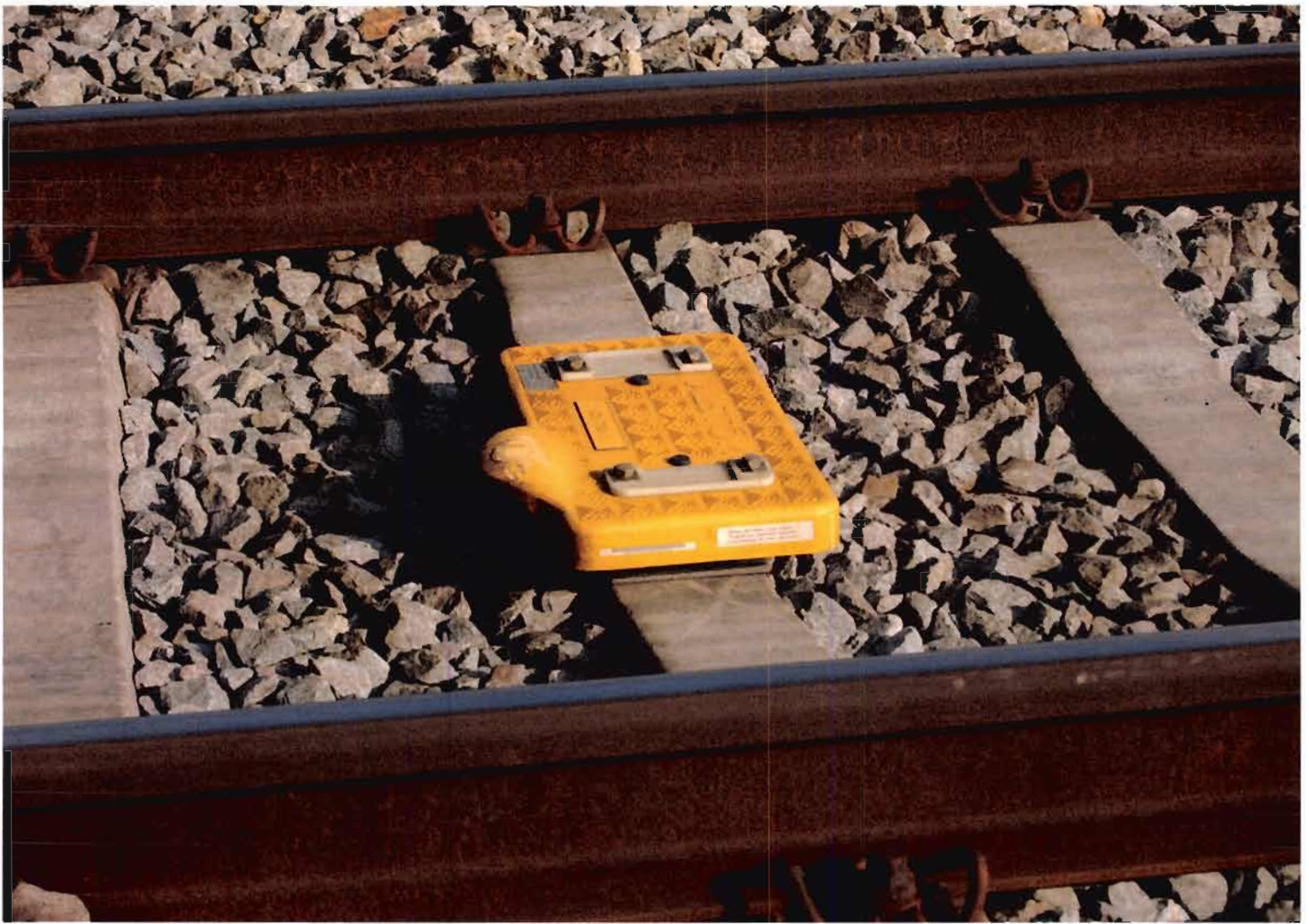
Balise in het spoor. Deze werkt als baken bij ERTMS.
