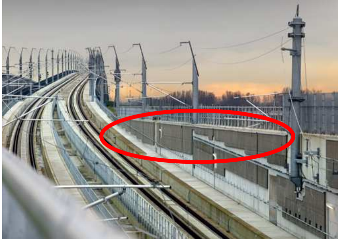
Figuur 5.5 Absorptiemateriaal bij de uitgang van de Groene Harttunnel
