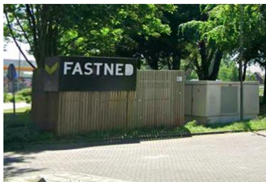
Figuur 11 Transformatorhuisje Sandelingen-Oost
