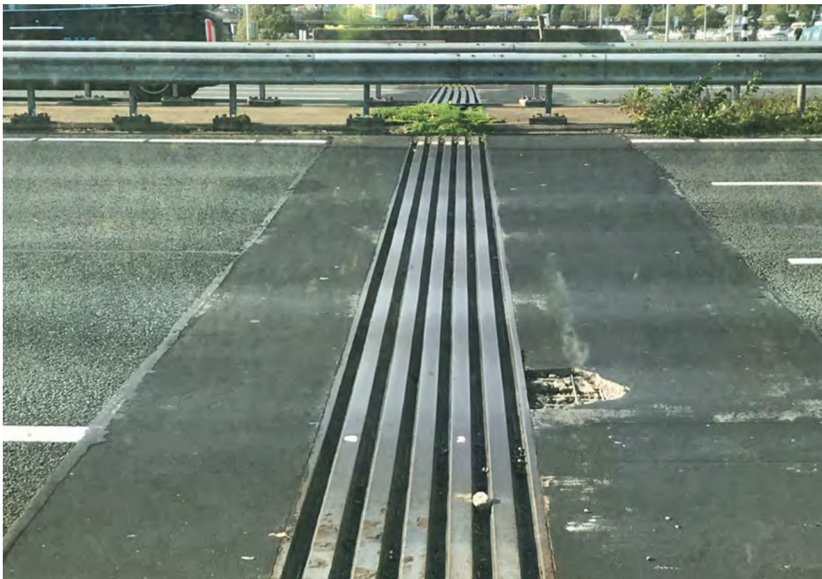
Schade aan het wegdek van de Zeeburgerbrug.
