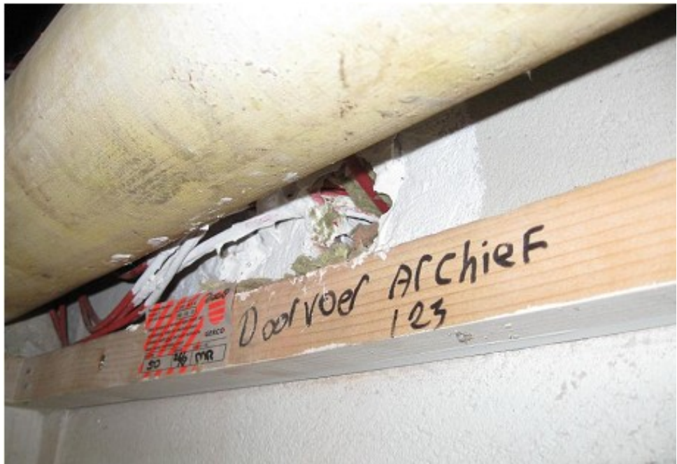
Onvoldoende afgedichte doorvoeren.
