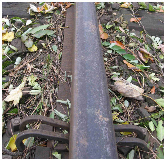
Afbeelding 4: spoorstaaf tussen de bladeren. Op het spoor zijn de afdrukken van de bladeren zichtbaar. Ook is de spoorstaaf zwart gekleurd, van de rijspiegel van de wielen van de trein (glimmend spoor van het wielcontact op de spoorstaven) is weinig zichtbaar.
