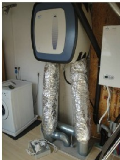
Figuur 25: Voorbeeld van een ventilatiesysteem waarbij de kanalen correct zijn geïnstalleerd. Geluiddempers zijn voldoende lang en strak gemonteerd. Bochten in de kanalen (vlak boven de verdiepingsvloer) zijn glad uitgevoerd.
