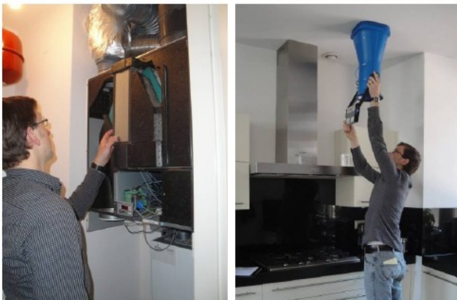
Figuur 3 (links): Visuele inspectie van het inwendige van een ventilatie-unit (balansventilatie) Figuur 4 (rechts): Meting van het ventilatiedebiet bij een afzuigventiel met behulp van een drukgecompenseerde luchtdebietmeter
