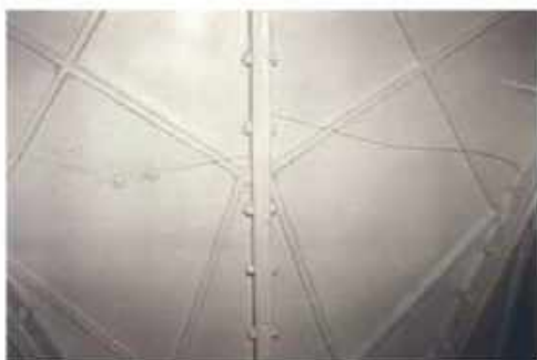
Foto 3, scheurvorming vloer (v.a. onderzijde)
