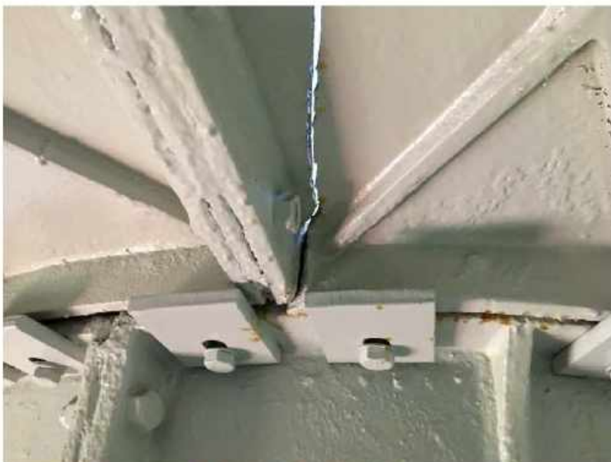
Figuur 3: scheurvorming bij "opleghandje" vloerplaat
