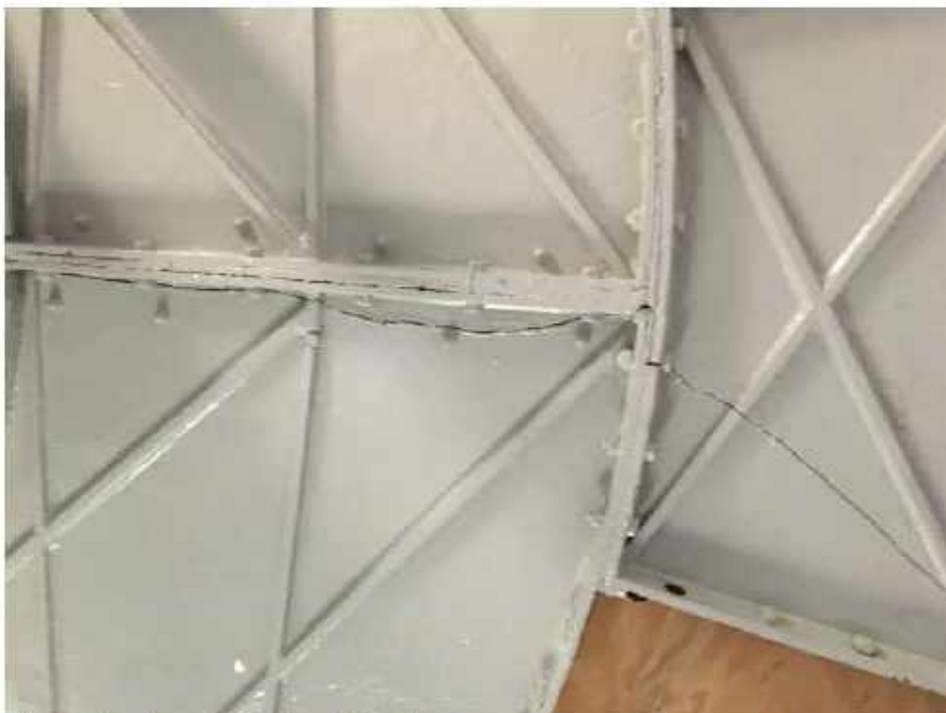
Figuur 1: scheur door vloerplaten heen
