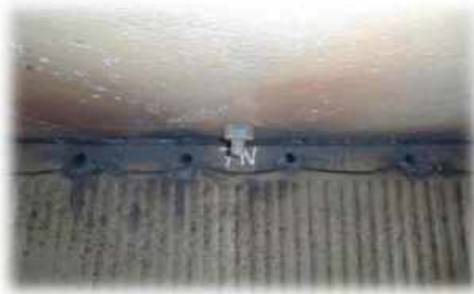
Plaat 7N, bouten verwijderd
