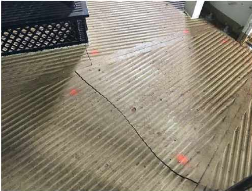
Figuur 2: scheur door vloerplaat heen
