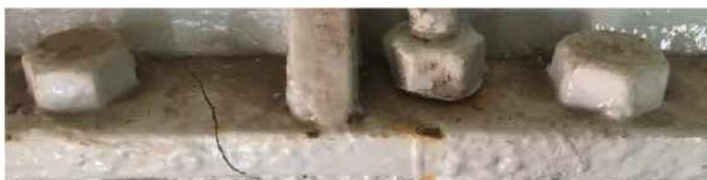
Foto 2, scheurvorming wandpaneel (binnenzijde van buitengevel)
