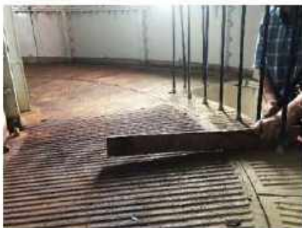
Foto 6: Zichtbaar scheve vloer
