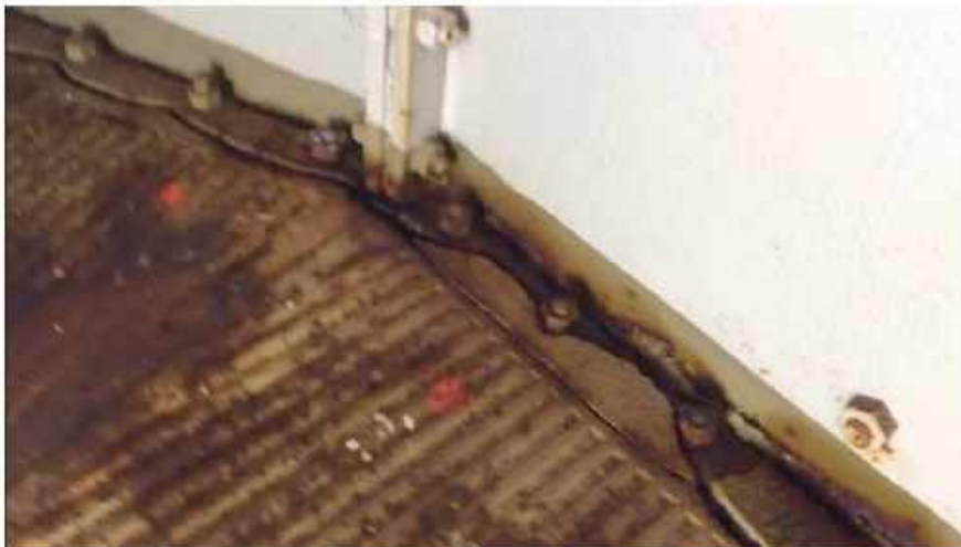
Figuur 7: scheurvorming langs vloerrand bij buitenschacht
