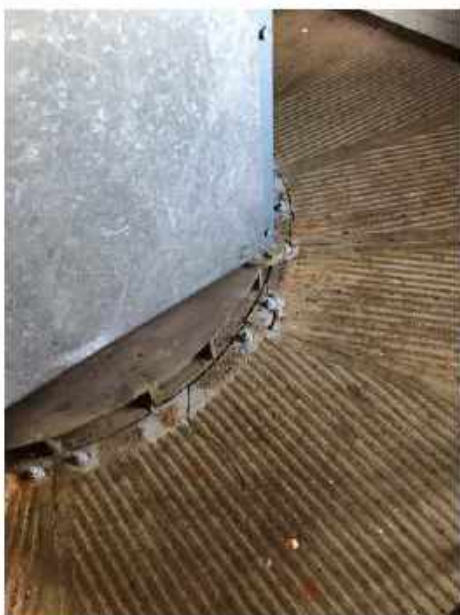
Foto 5: Vloer los van de binnenschacht
