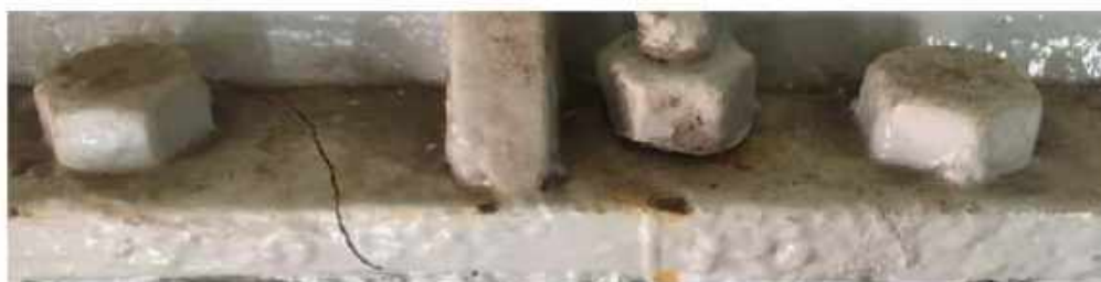
Foto 2, scheurvorming wandpaneel (binnenzijde van buitengevel)
